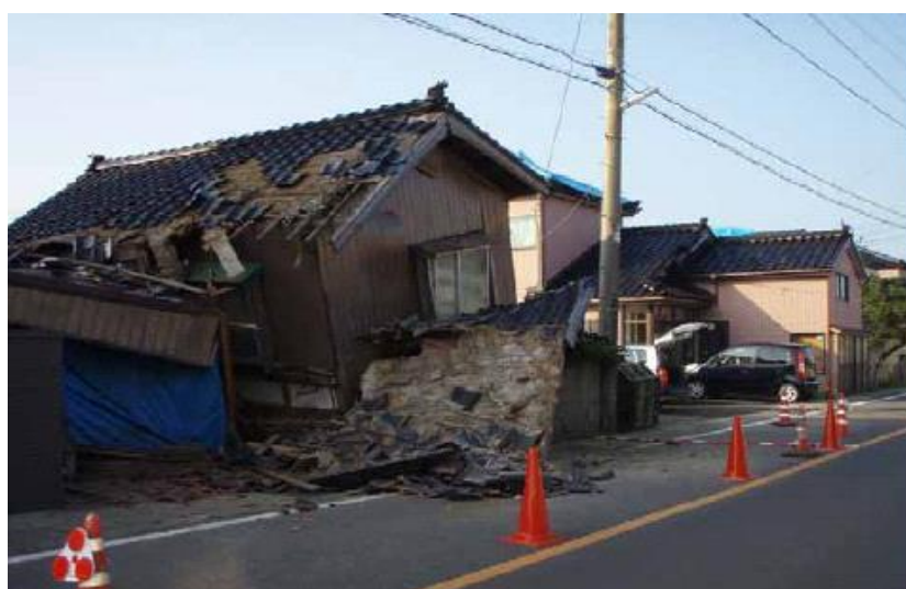
(出典：新潟県中越沖地震被害状況)
