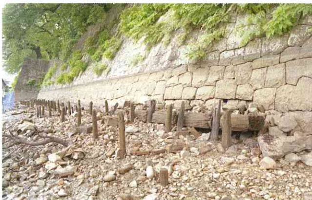
本丸の石垣 補修跡（三階櫓と隅櫓の間）
