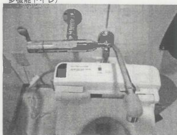
オストメイト簡易型設備（7F 多機能トイレ）
