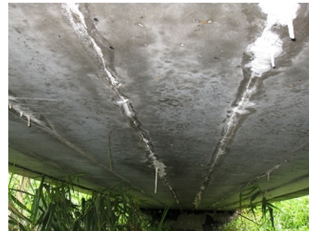
コンクリート桁の漏水・遊離石灰等
