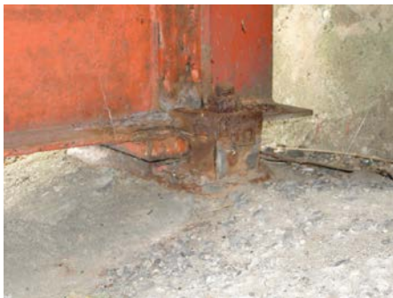
鋼部材の腐食等
