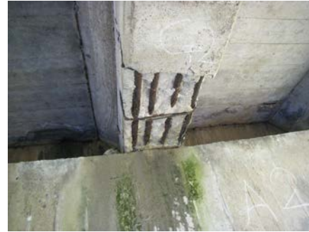
コンクリートの剥離・鉄筋露出等
