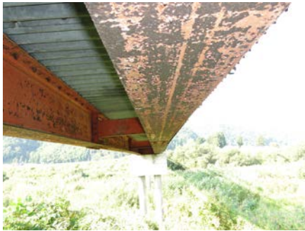
鋼桁の腐食等
