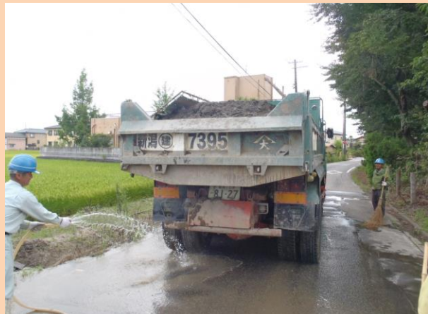
残土運搬時、ダンプトラックに付着した土砂を除去し、周辺の環境対策を講じた。
