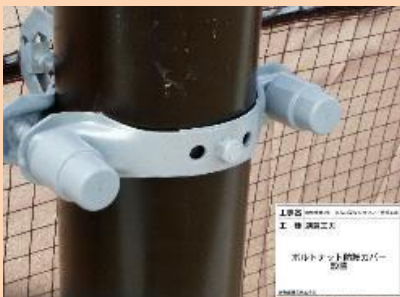
防球ネット固定具が児童の頭部くらいの高さで、突出している為、塩ビ製のボルトカバーを設置。
