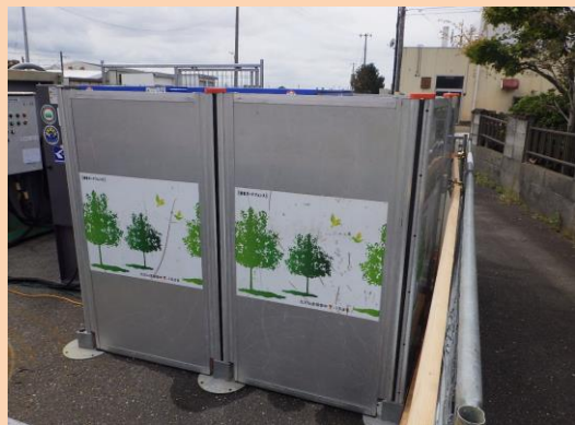
発電機を吸音パネル仮囲い
