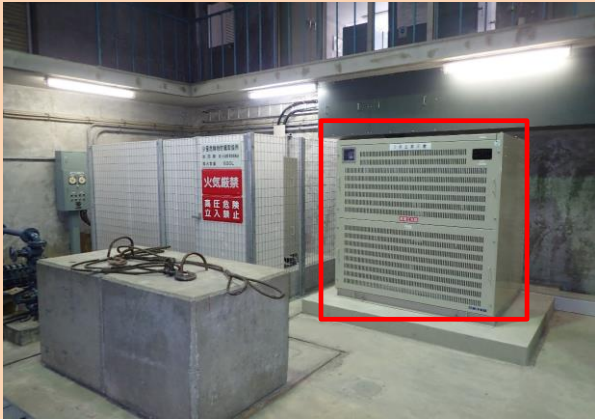
更新前:地下ポンプ室
