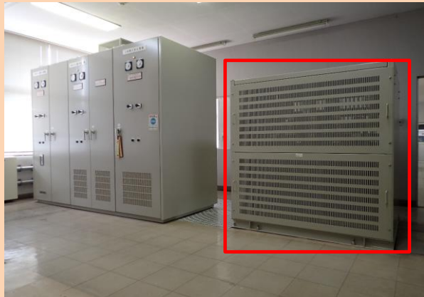
更新後:地上階:電気室
