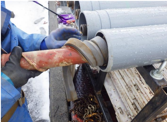
スクリューにスポンジを巻き、掘削土砂の取り込み過ぎを低減
