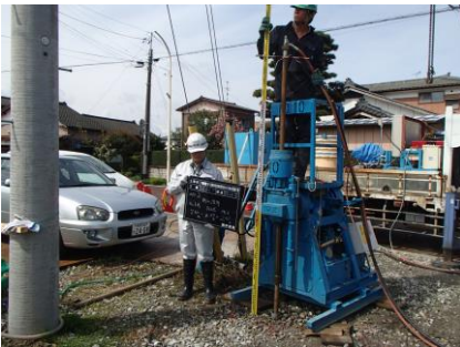
下水道管渠と交差する推進管(用水)の埋設深度を探査ボーリングにより調査。
