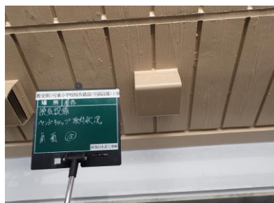
外壁色に統一した吸排気耐外風フード
