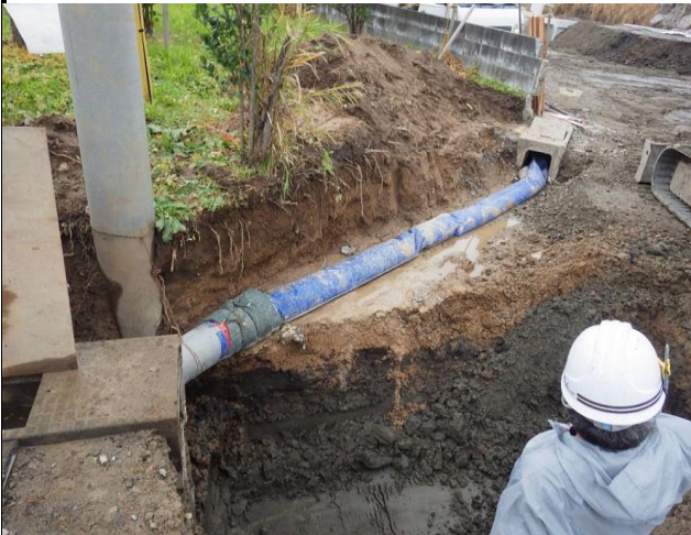
ポンプを使用せず仮水路設置により騒音の防止を行った。
