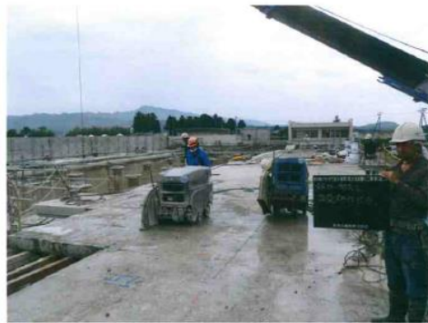
・カッター切断状況 ロードカッターによるコンクリート切断
