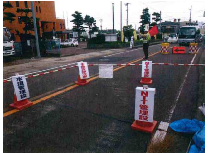
既設埋設管や架空線位置を誰でもわかるように視覚的に明示した
