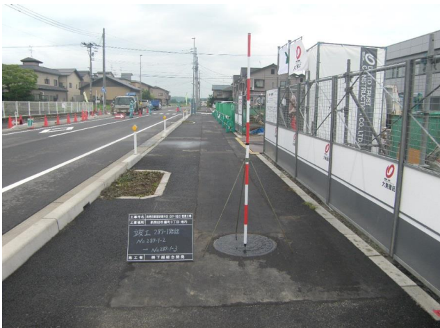
工事箇所沿線の集合住宅の引き渡し、供用開始時期の制約がある中で余裕をもって工事完了することができた。
