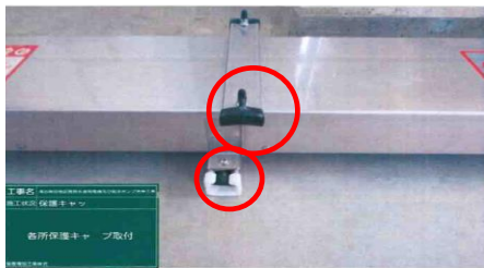
金具、ボルトにキャップ、保護器具を取付することによる引掛け事故防止措置。
