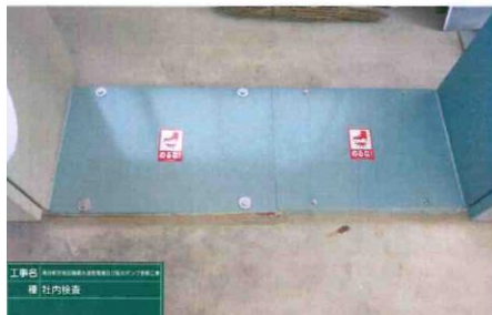
踏み抜き防止注意喚起措置。
