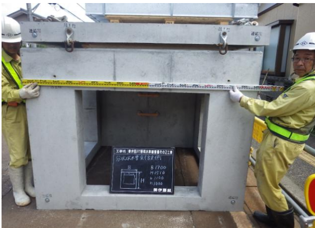
分水柵工 現場打ち分水柵を工場製作し、工期の短縮を図る。
