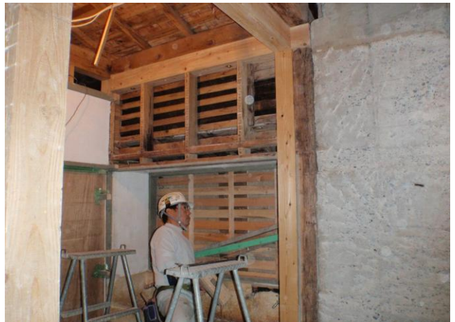
調査の結果、渡り廊下の木部が腐食していたので補強した。
