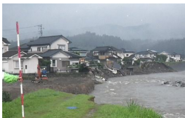
河岸侵食による家屋の倒壊(花月川)
