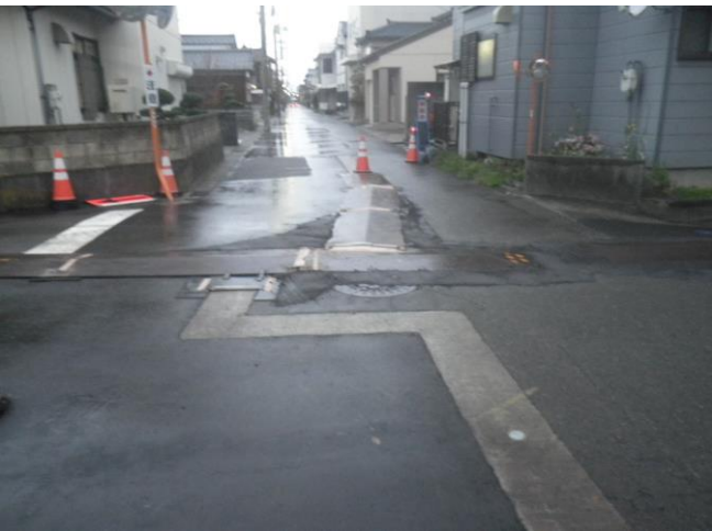
養生鉄板段差解消状況
