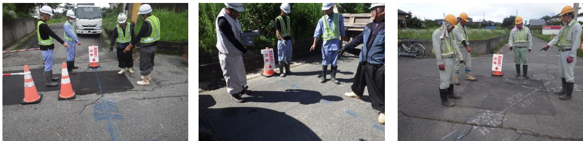
・試掘調査を徹底して行い既設水道管や既設雨水管等の状況を把握し現地に記したこと、試掘結果情報を作業員全員で共有することにより、他埋設物の破損事故起こすことなく、工事を完了させた。
