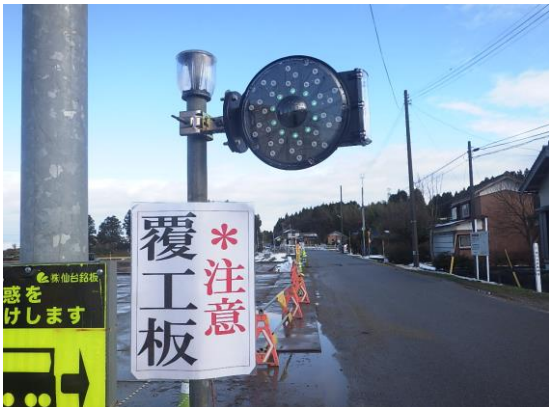
覆工板段差部の夜間照明設備の配置
