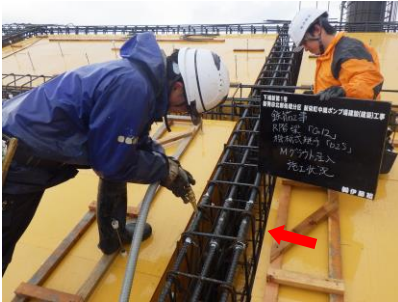
RF部の登り梁筋筋の施工に伴い、ガス圧接時の鉄筋収縮を考慮し、機械式継手を採用。所定の精度を確保することができた。
