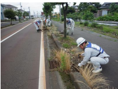
地下階土木工事の請負者(伊藤組)とともに社員20名以上を動員して現場周辺の草刈りと清掃を実施。
