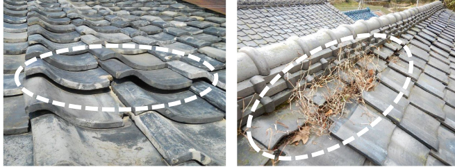
瓦に浮き上がりが生じている
