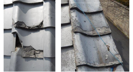
瓦が著しく破損している例
