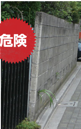
傾いている危ない塀
