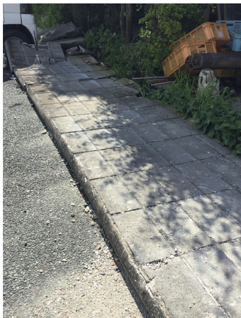
地震によりブロック塀が倒壊
