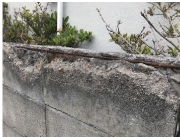
割れや鉄筋の露出がみられる塀
