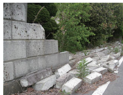
地震により石塀が倒壊
