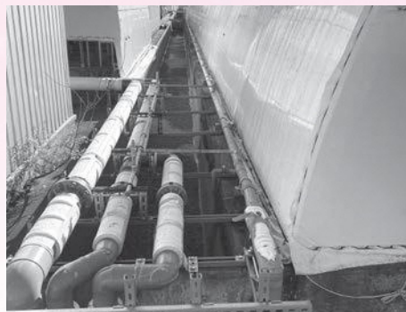
豪雪地の横手市でハウスの空調、融雪対策に地下水を利用（写真はハウス間の融雪槽）
