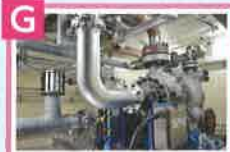
+ 高圧代替注水ポンプ (制御電源不要)
